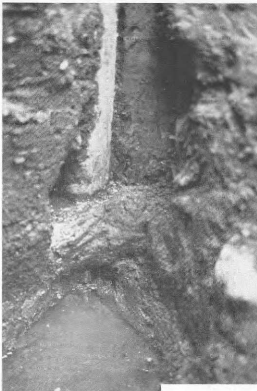
15. Foderrör P4, nedre del i detalj.
