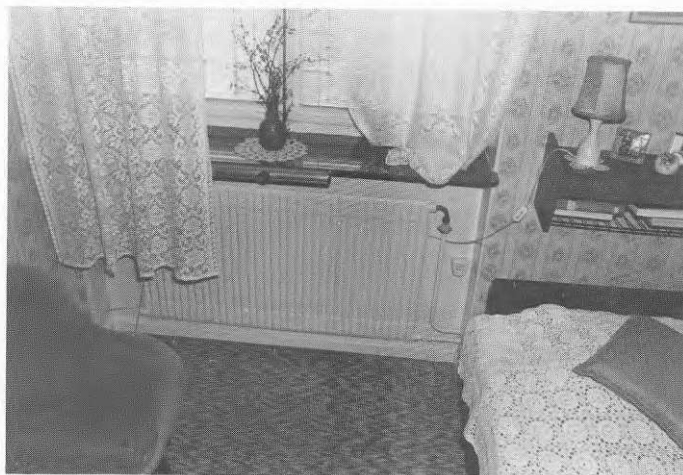
Figur 4.38 Radiator med ovanförliggande springventil, Filaren 7
