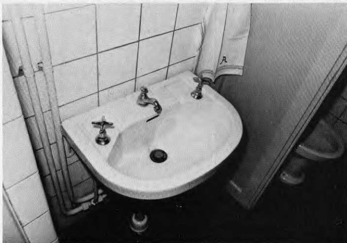
Figur 2.17 Tvättställ med vattenblandare. Det var annars vanligt med separata tappventiler
