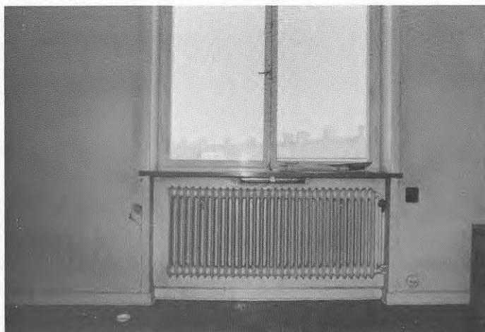
Figur 4.21 Radiator med ovanförliggande springventil, Jakthunden 4
