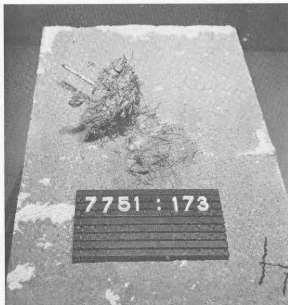
Figur 8.5. Spik med cirkulär bricka utdragen ur fiberputsen.
