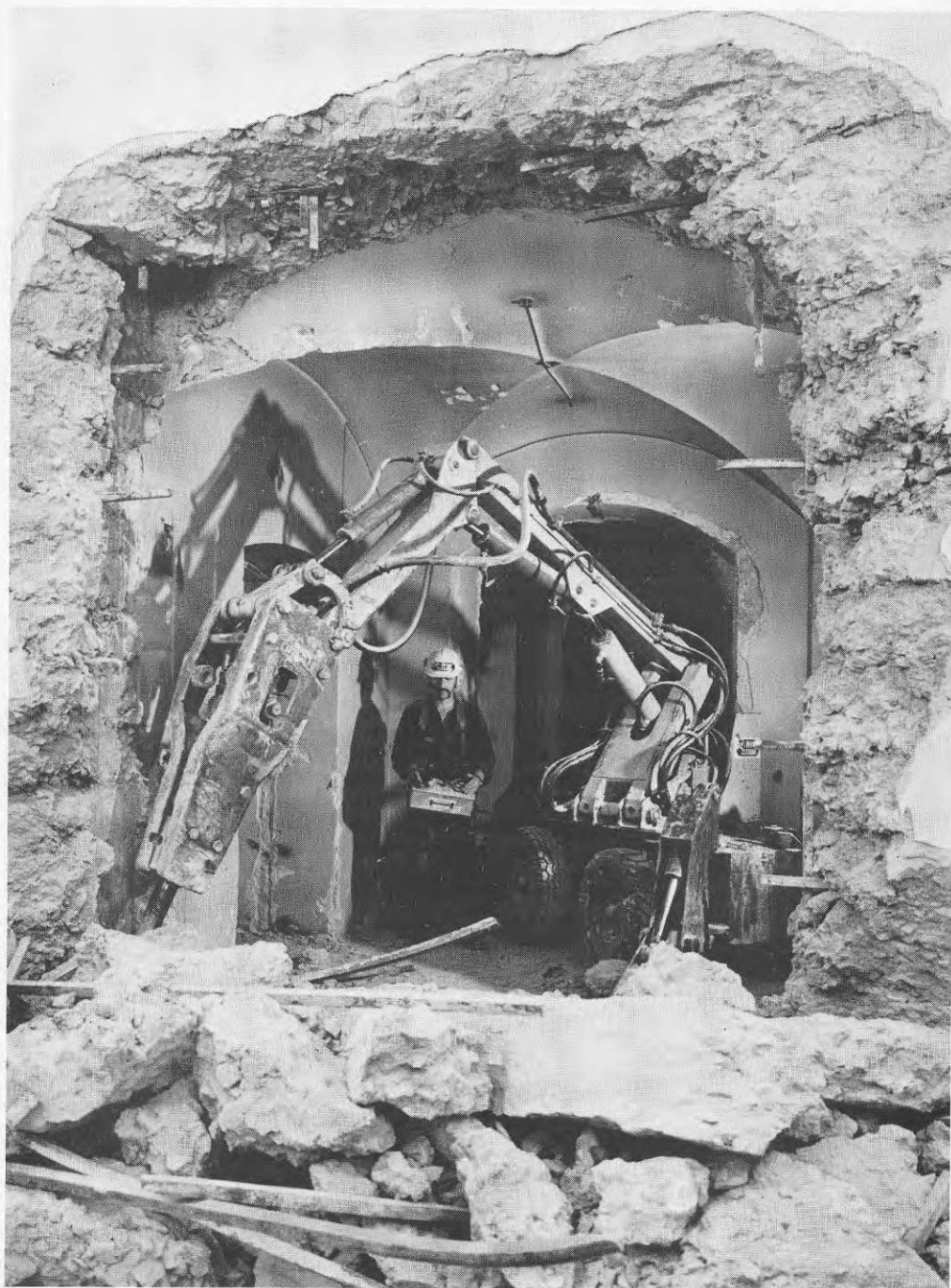
Figur 3. Rivning av gamla Riksbankens guldvalv på Helgeands- holmen. Rivningen utfördes med en hydrauldriven bil- maskin monterad på en bärvagn. Observera att föraren står bredvid vagnen och styr, på så sätt undgår han maskinens vibrationer.
