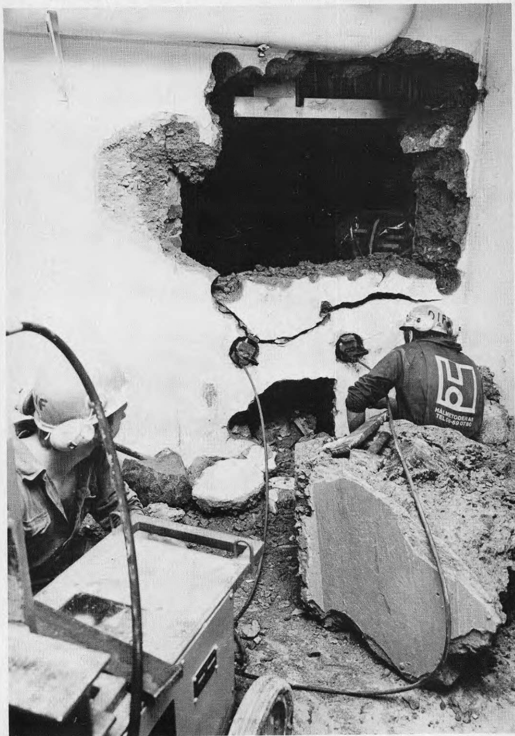
Figur 18 c) En stor bit av väggen är bortspräckt.
