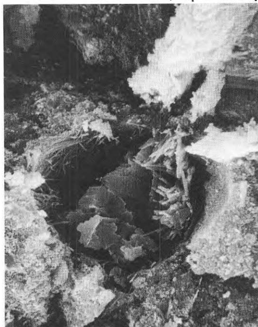
Fig 81 Skurubron, saltskadad betong, saltfylld (?) luftpor (MF)
