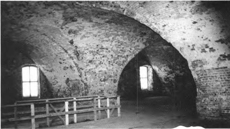
Fig 1 Saltskador i kalkade tegelvalv, Sveaborg, Finland (ThP)
