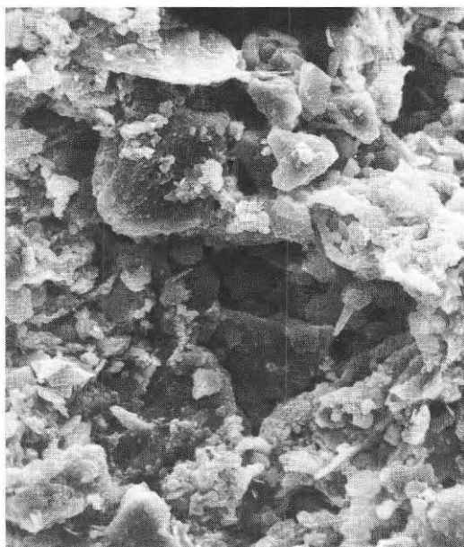
Nedbrytningsprodukter (vittring) på fasadyta
