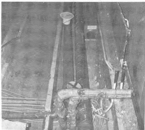
Figur 36. Kanaldragning i golvbjälklaget ger konkurrens om utrymmet.
