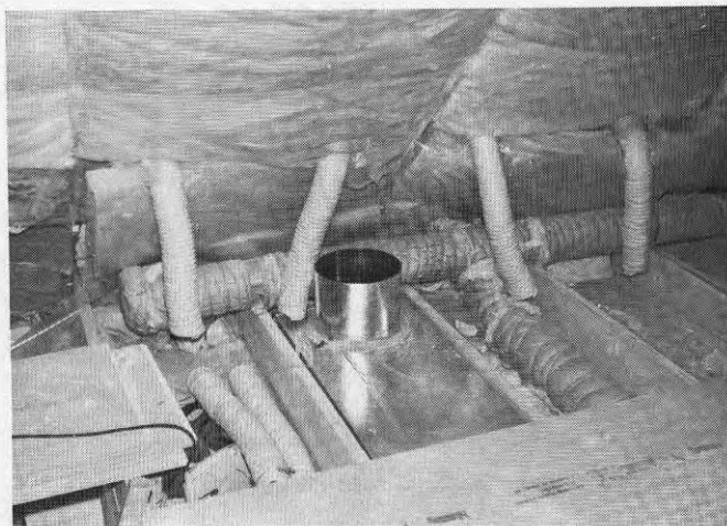
Figur 31. Kanaler installerade i golvsbjälklaget.
