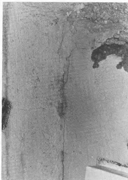
Figur 3.19 Spricka som förorsakar luftläckning vid infästningen av murad betongblockskanal vid fläkt.
