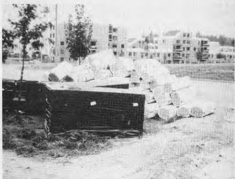
Bild 4.16 Fel lossad isolering
