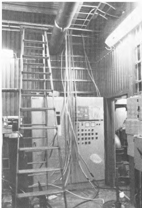
Fig 11. Automatikskåp med del av kablage
