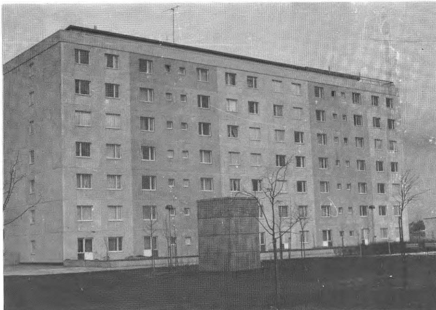
Fig. 23. Slät, sammanhängande betong-elementfasad. Fördelningen av skadorna på fogsträngarna visar att denna fasads fogar är hårdare påkända än balkongsidans, se Fig. 3. Skadorna är störst vid de stora elementen.
