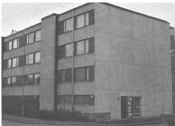
Fig. 13. Hus belägna i en nord-sydlig dal. I gavlar mot norr och söder har samlats läckvatten som trängt in i golvet i bottenvåningen. Sedan fogen vid sockeln öppnats har läckvatten försvunnit.
