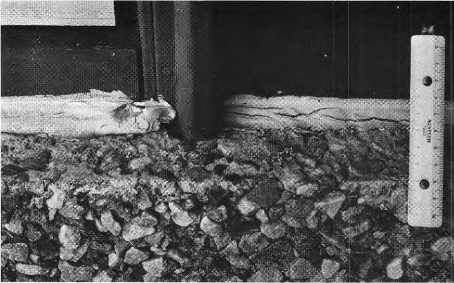
Fig. 81. Fog med tunn oljebaserad, skinnbildande fogmassa. Rörelserna i träpanelen p.g.a krympning vinkelrätt mot fibrerna har åstadkommit kraftiga sprickor i massan. Fogen har lagts med mindre god finish. Observera skadorna på fönstret. Fotot taget efter 2 år i västfasad.
