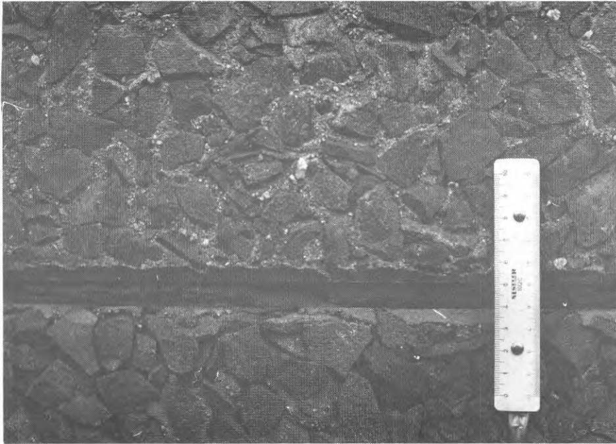
Fig. 72. Brott i svart akrylbase-rad, plastisk fogmassa. Brottet har skett i den relativt tunna fogmassan vid en skarv i botteningslisten, som består av polyeten med öppen struktur. Listan har troligen sträckts vid inläggningen. Krympning i fogmassan kan möjligen ha bidragit. Fogmassans yta är knottig. Fotot taget i fasad mot väster efter 2 år.
