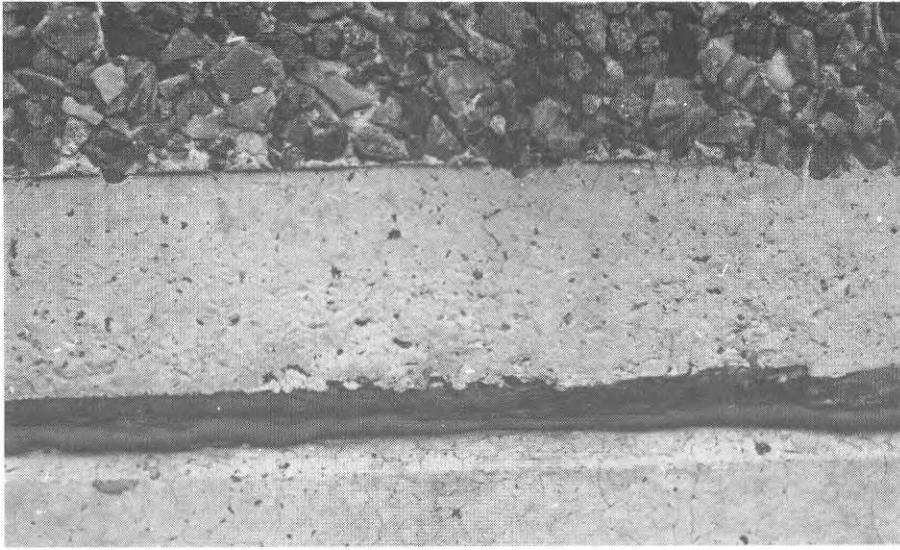
Fig. 33. Horizontalfog vid grundmur, utsatt för sättning-rörelse. Rörelsen har troligen sin orsak i eftergivlighet i upp-lag och nedböjning hos bjälklag på vilka elementen vilar. På grund av rörelsen har fogmas-san knäckt ut.
