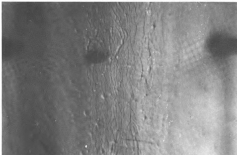
Fig. 99. Ytsprickor i polysulfidfogmassa vinkelrätt mot töjningsriktningen. Fogmassans yt-skikt är sprött. På ytan syns spår efter blåsor. Skala: Det svarta blyertsstiftets diameter = 0,92 mm.
