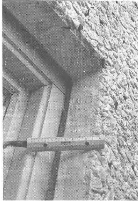
Fig. 46. Odränerad fog vid överkarmstycke. Läckvatten som samlats vid fogen har långsamt trängt ut genom betongen och fällt ut kalk på karmstycket. Fasaden uppvisar in- och utvändiga fuktskador.
