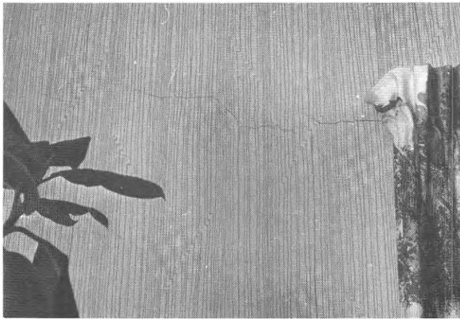
FIG. 18. Lättbetongsprickor. Horisontell spricka vid överkant fönster.
