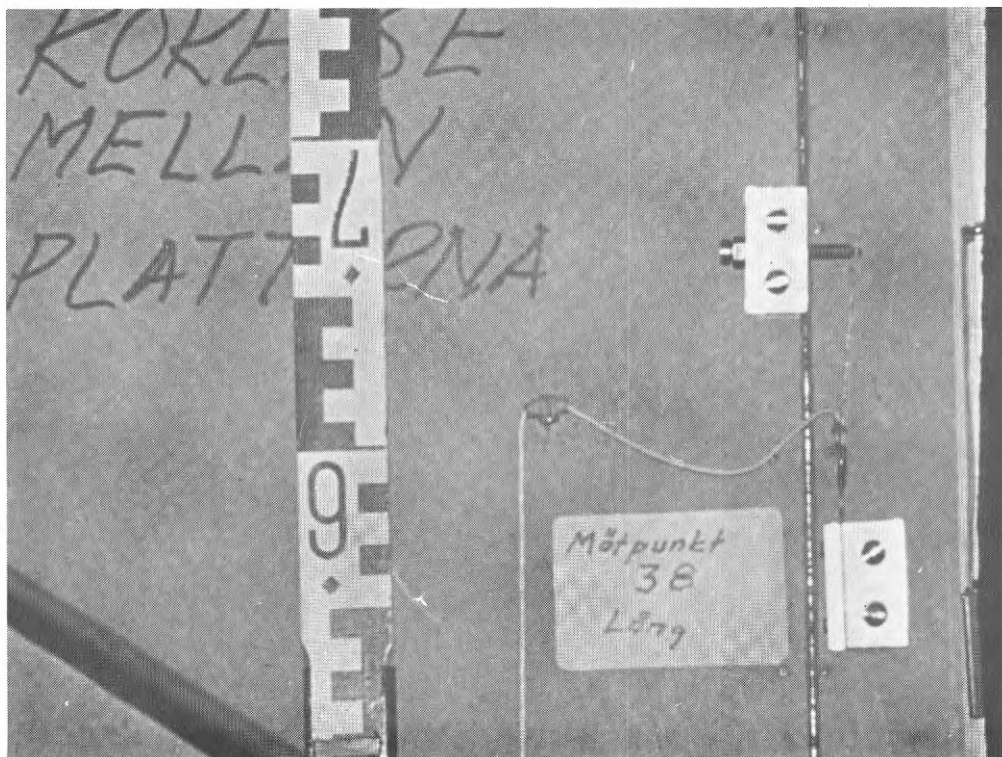
FIG. 95. Mät punkt 38, glipning i skivskarv invid fönster i PH rum 1, anflygningsriktningen.
