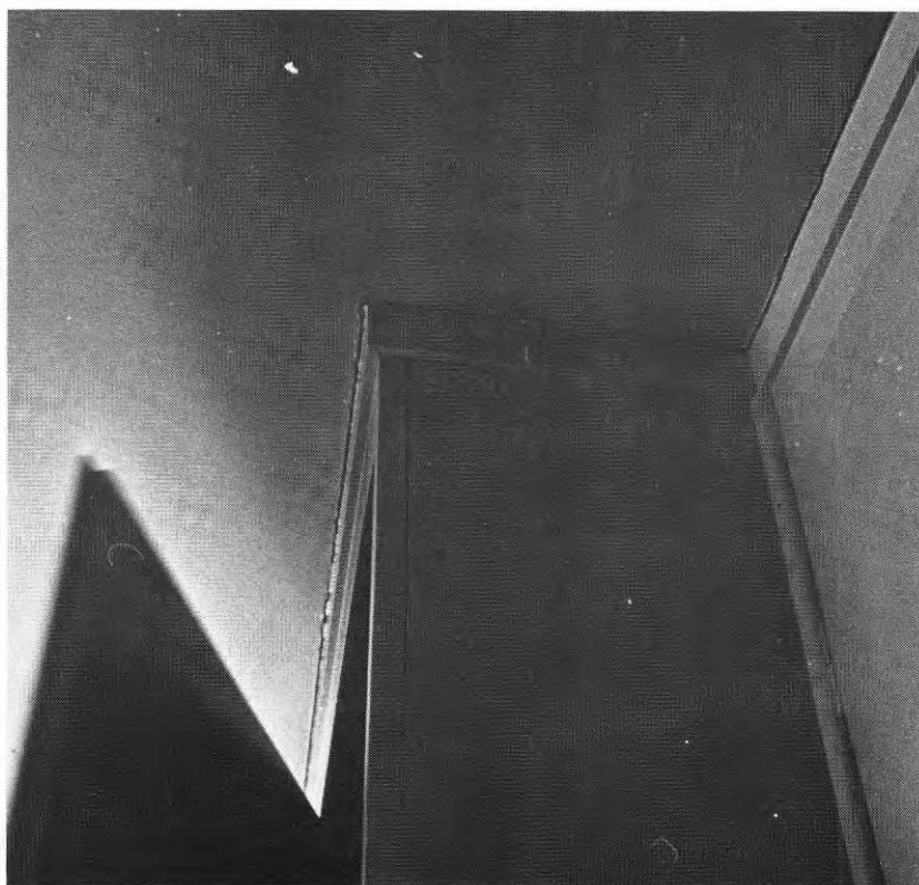
FIG. 46. Springor i och omkring skåpsinredning. Skåpet har sjunkit så att en springa uppstått i takanslutningen. Skåpfronten har slagit sig.
