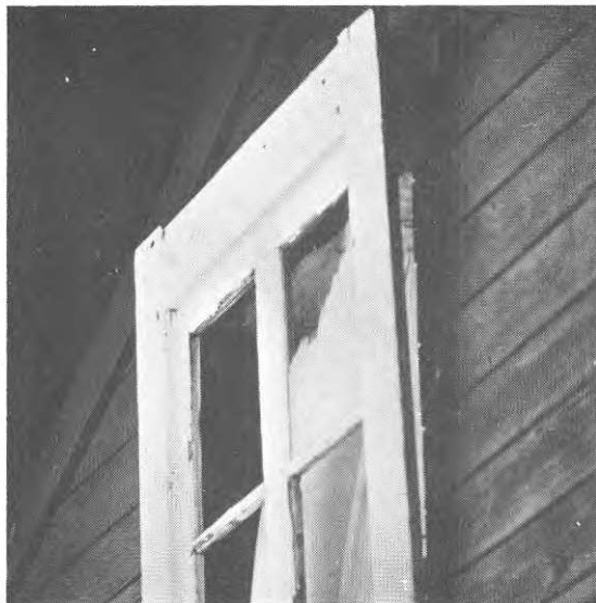
FIG. 121. Vindsfönstret i Nilssons hus som lossnade vid flygning 7:1.
