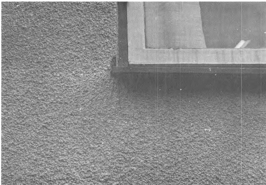
FIG. 37. Putsspricka vid fönsterhörn på reveterat trähus.
