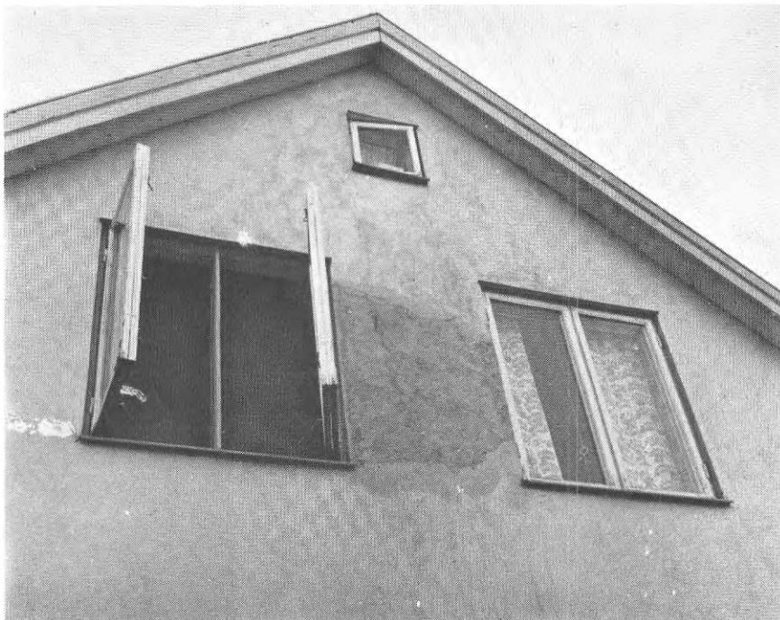
FIG. 39. Lossnad puts på träunderlag. Efter en ljudbang upptäcktes att ca 1 \text{ m}^2 av putsen fallit ner.
