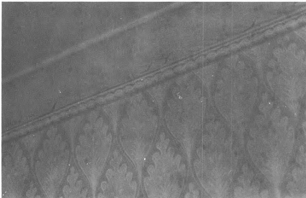
FIG. 43. Sprickor i papper över hålkälslist i takvinkel.
