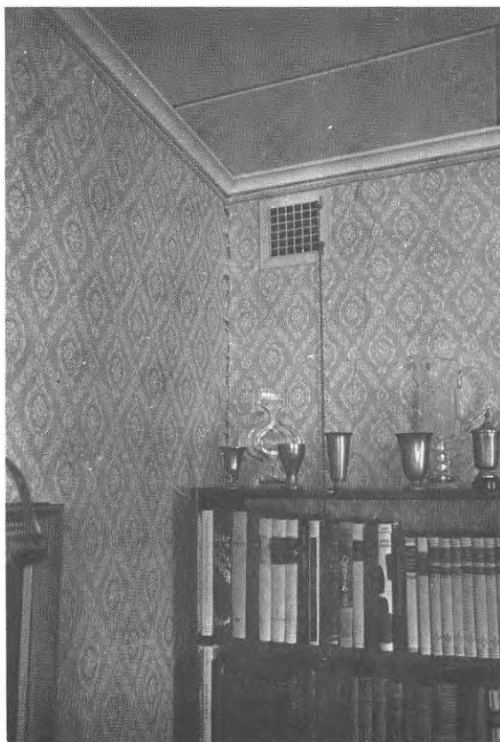
FIG. 44. Tapetsprickor över anslutning mellan skorstensstock och trävägg.
