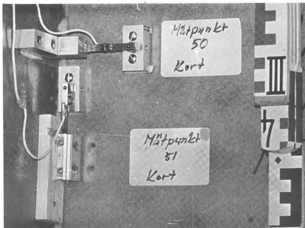
FIG. 116. Mät punkt 50 och 51, rörelse mellan två ytterväggar, PH rum 2.
