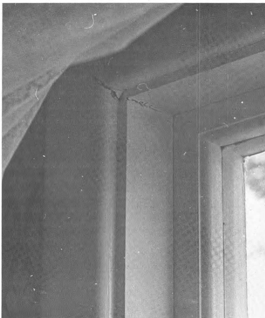
FIG. 26. Målningssprickor i fönstersnickerier.
