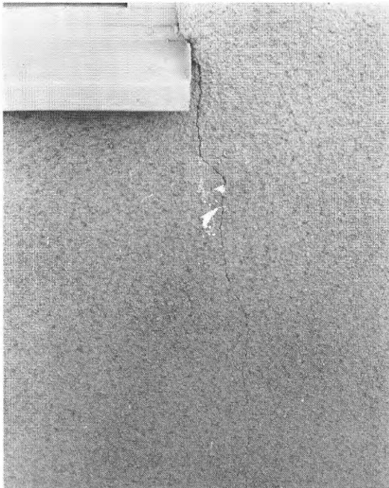
FIG. 19. Lättbetongsprickor. vertikal spricka i fönsterbröstning.
