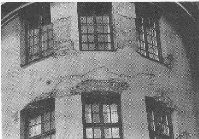
Fig 8:1 Putsnedfall förorsakas ofta av felaktigt utförd grundning eller för kraftig uttorkning. Sprickbildning förorsakar vatteninträning och detta för så smaningom med sig att putsen ramlar ned. Skadorna kan bli mycket omfattande om ett organiskt ytskikt används.
