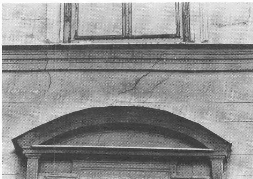
Fig 8:2 Sprickor som går in i stommen förorsakas ofta av sättningar i grunden. Då fasaderna är i behov av fullständig omputsning är det riktigt att åtgärda dessa sprickor med hjälp av armering.
