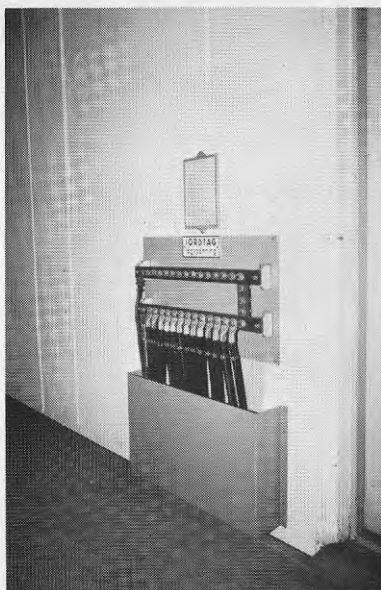
FIGUR 23 Sammankoppling nolla-jord utanför ställverk
