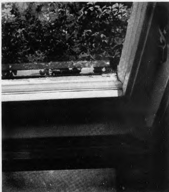
Figur 2.3 Färgavflagnig på yttre bågbottnestyckets översida i köksfönster mot sydost i villan i Oxie. Skadan orsakad av kondens mot insidan av det yttre glasets nedre del.
