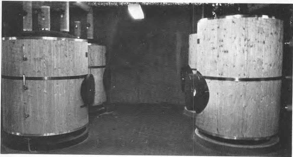
Figur 12. Ackumulatortankar för tappvatten. De två tankarna till höger är kopplade till värmepumparna.
