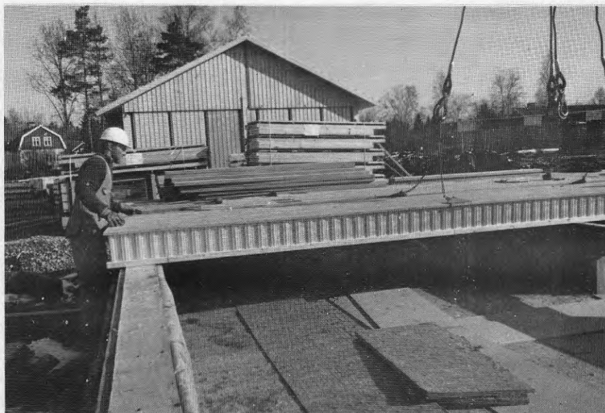
Figur 18 Montering av bjälklagelement har påbörjats. Bilden visar också de krypbanor av spånskivor som lades ut i de varma kryprummen för att underlätta krypning och minska skador på isoleringen samt uppbyggnaden av de bjälklagelement som användes vid de varma kryprummen.
