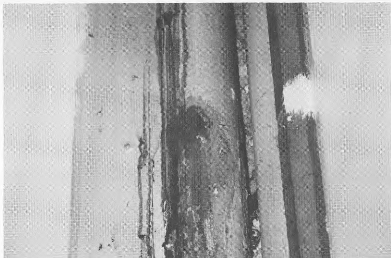
Figur 3.9 Genomgående punktfrätning med krusta på utsidan skada 3, på stam 3, 1 tr i fastigheten Sjökattnen 10
