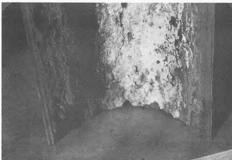
Figur 1 "Baggen 15". Prov 1. Vy av insidan med avlagringar
