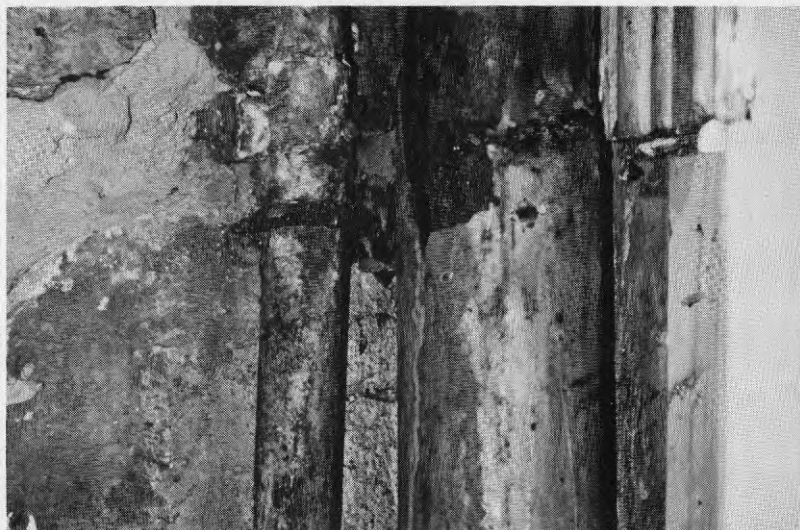
Figur 3.11 Stam 2, bv, i fastigheten Sjökattnen 10. Spräckt rör till följd av provisoriskt renshål. Notera det yttre oskadade ljusgrå gjutjärnet i brottytan och det inre svarta grafiterade skiktet.
