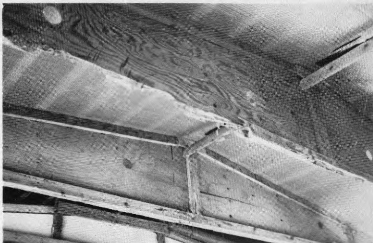
Termitangrepp på obehandlade tak- stolar i Bai Bang.
