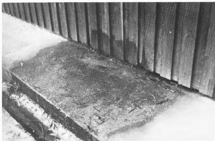
Kondensvatten från luftkonditionering. Fukt intill trävägg skapar termitvänlig miljö.
