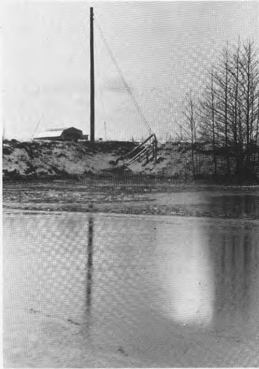
Bild 3 och 4 Intagsanordning för sjövatten.
