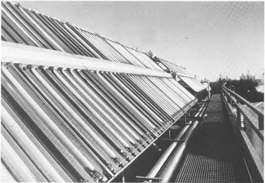
Figur 1:10 Solfångarinstallationen på Knivstaverket i Uppsala
