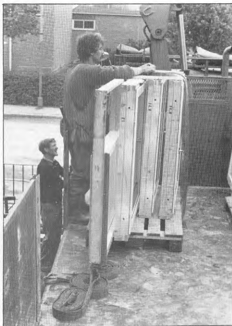
Fig 15. Fönster stående på pall.
