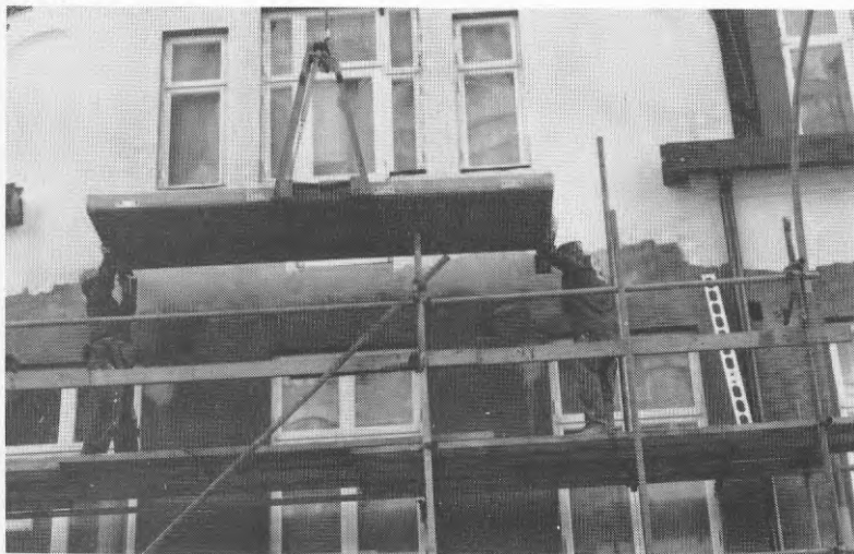
Figur 18. Montering av balkongplattor i syrafasta kassetter (utvecklad i samband med detta arbete).
