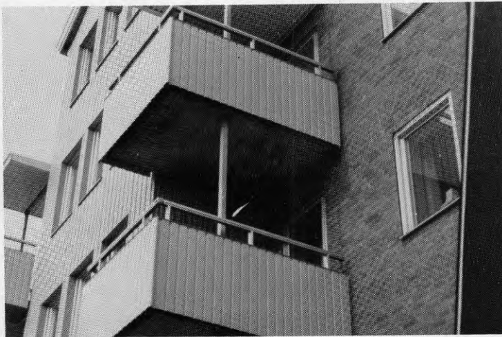
Figur 6. Bild av balkong med lagat vertikalt bärverk.
