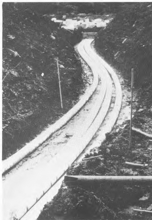
Figur 7.9 PEM-rör isolerade med rörskålar av frigolit utgör förbindelse mellan markackumulatören och apparatrum.
