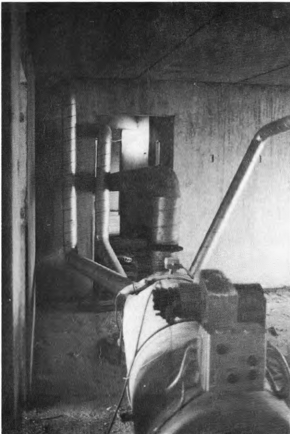
FIG. 26. Byggtork uppställd i ett elementbyggt hus. Via ventilationskanalerna leddes värmen till utrymme där elementmontering pågick.
