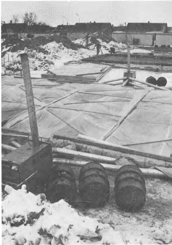
FIG. 11. Vid kontinuerlig småhusproduktion vintertid återkommer vanligtvis arbeten med tjälting med vissa mellanrum. En lösning kan som här vara att placera låga plastfolietäckta träsektioner över marken. I dessa hålls sedan luften uppvärmd med byggtorkar. Vid detta objekt tinade man 40 cm tjäle på 2 dygn.
