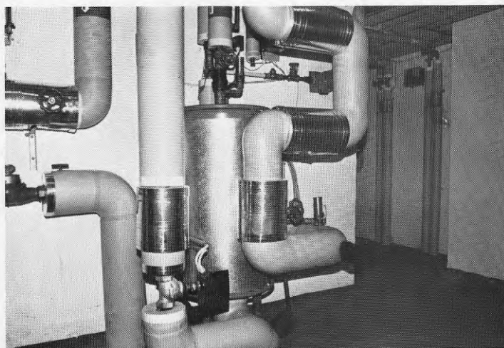
Fig 3.3. Foto av varmvattenvärmare för eftervärmning av tappvarmvatten.
