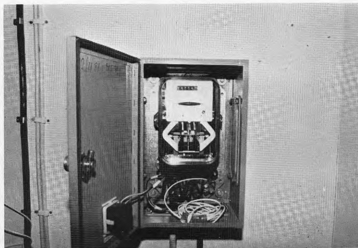
Fig 4.1. Foto av elmätarskåp.
