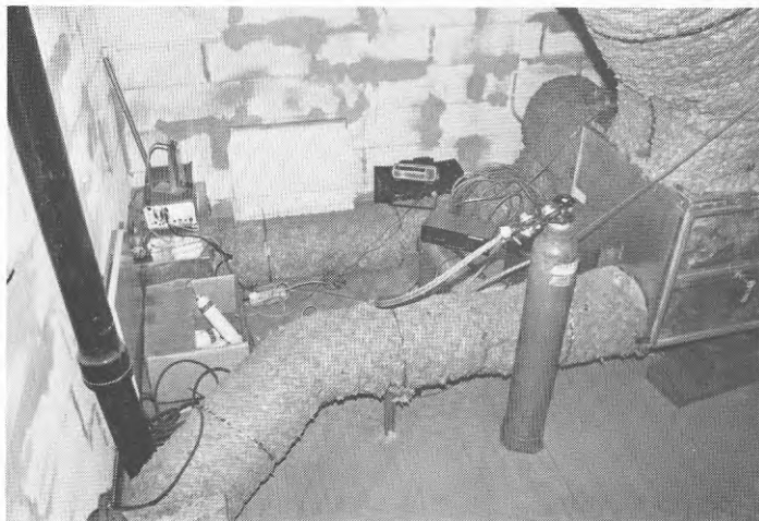
Fig 3.4 Foto av fläktrum.
