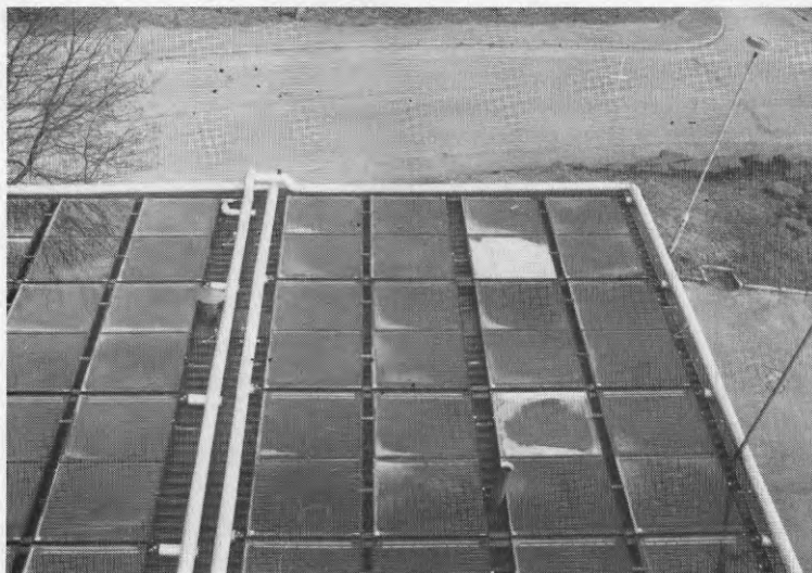
Solfångare på apparatrummet riktat mot väster. Kondensutfällning förekommer på vissa enheter.
