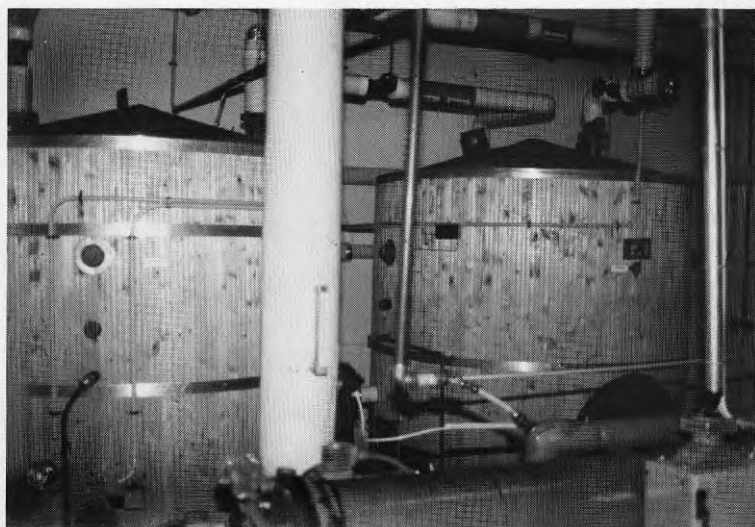
De två varmvattenackumulatorerna på vardera 2,5 m 3 kopplade i serie.
