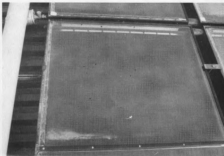
Närbild på solfångare efter tre års drift. Trots kondens kan ingen synbar förändring på absorbatoren konstateras.
