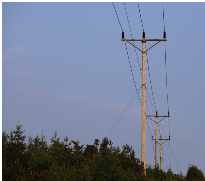
Figur 12. Trästolpar med uppåtstående porslinsisolatorer.
