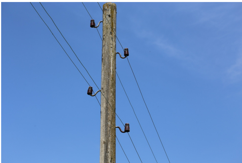
Figur 16. Lågspänningslinje med krokhängda porslinsisolatorer och koppartråd
