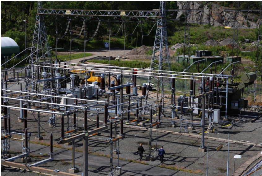
Figur 15. Transformatorstation med ställverk.
