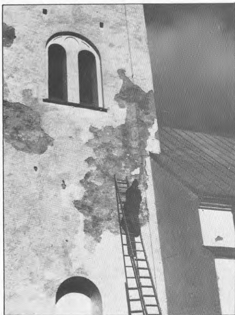
FIG. 5:15. Skadeutseende efter första renoveringen, översikt.
