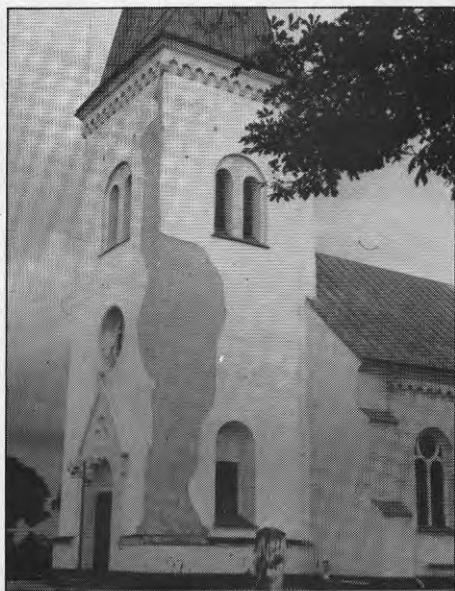
FIG. 5:17. Skadeutseende efter andra renoveringen, översikt.
