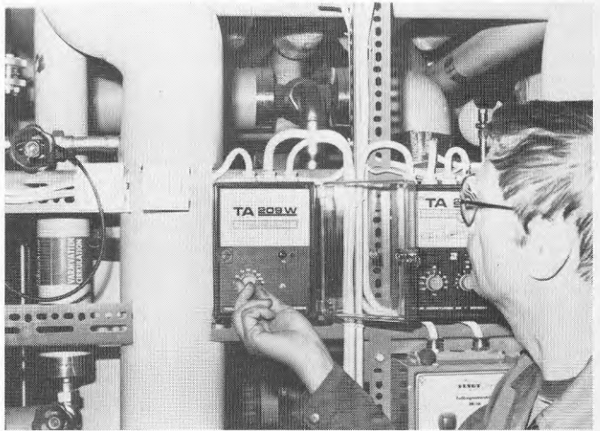
Inställning av varmvattentemperatur
