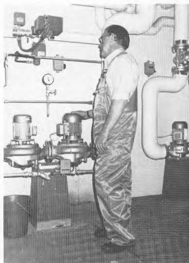
Kontroll av cirkulationspumpar för värme
