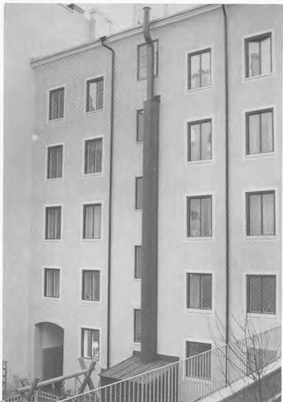
a. Vid ombyggnader av gammal kvartersbebyggelse har ibland sopnedkast installerats, med soprum på gården. Foto: Eva Eisenhauer
