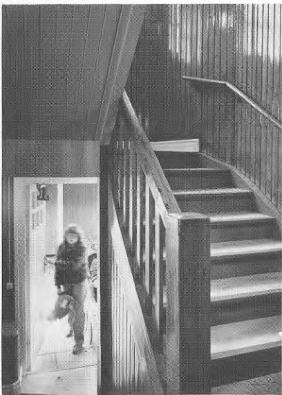
Trapphusets träpanel har kunnat bevaras genom att sprinklersystem satts in.
