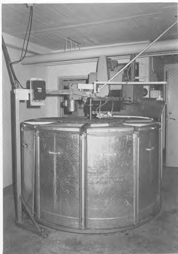
c. En kort skruv från ett befintligt nedkast kan föra soporna till en lättåtkomlig säckväxlare
