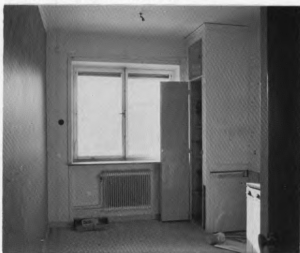
c. Friskluftsventilerade skafferier finns i allmänhet. Under den - här utrivna - låga arbetsbänken satt ett litet kylskåp. Överskåp saknades över disk- och arbetsbänk.
