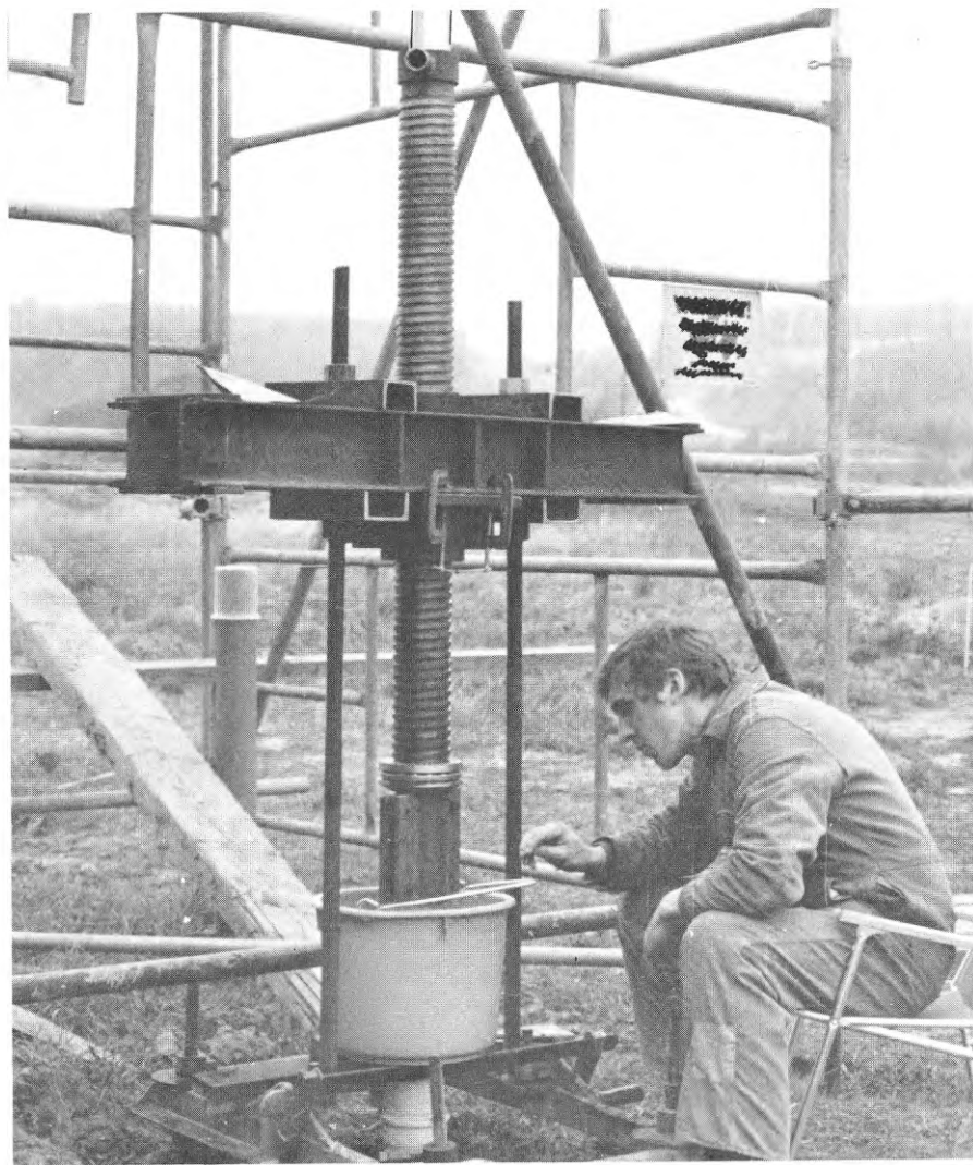
FIG. 43. Neddrivning av pålarna i provyta D. Driving of piles in test area D by means of a screw jack.
