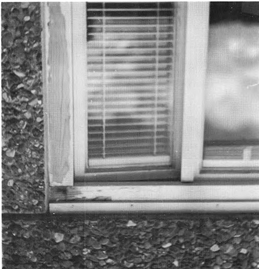
FIGUR 1. Fuktskador på fönsterkarm i bostadshus.
