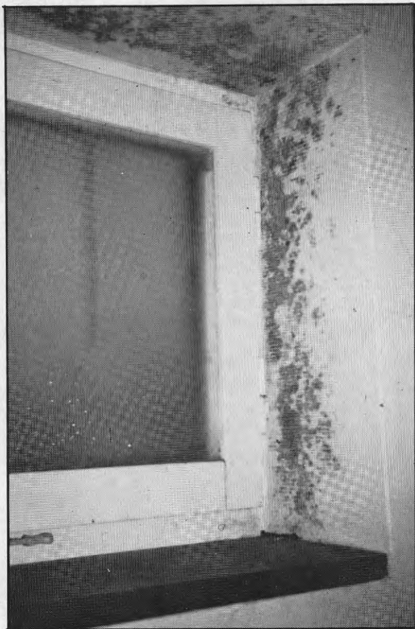
Mögelangrepp i fönstersmyg. Ytskiktet består av latexfärg på glasfiberväv.
