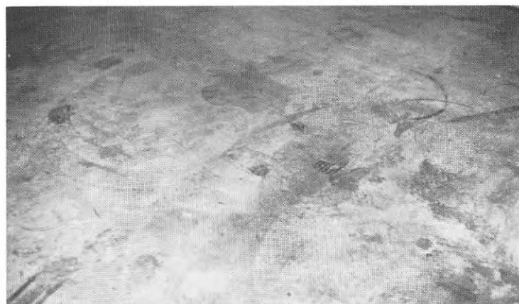
Bild 19. Missfärgning, klar epoxi, utställningshall.
