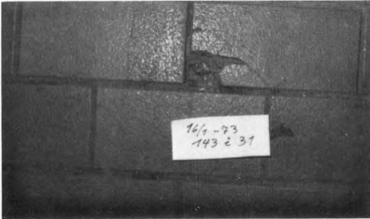
Bild 4. Obehandlat klinker, kross-skada.
