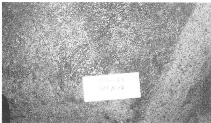
Bild 41. Fluat, 13 år, personbilsgarage med hård trafik. Ytbehandlingen intakt över stora ytor.
