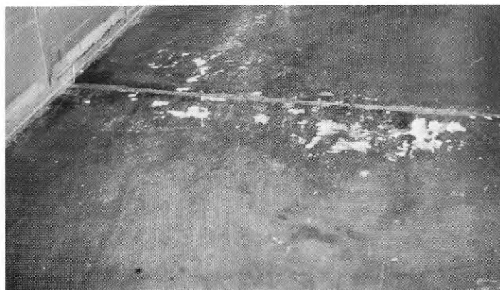
Bild 34. Vanlig skada intill golvskarv.
