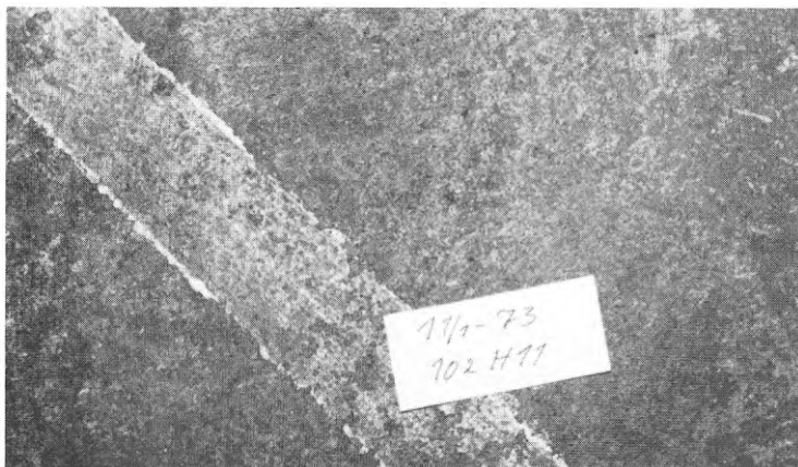
Bild 40. Fluat, som bild 39, små betongskador i hjulspår.
