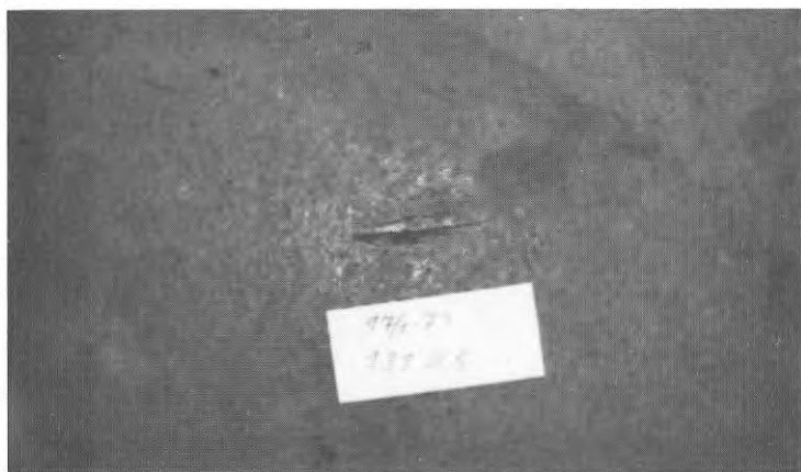
Bild 13. Krossningsskada, epoxi, ca 1,5 mm tjock, 0,5 år gammal, torrutrymme.
