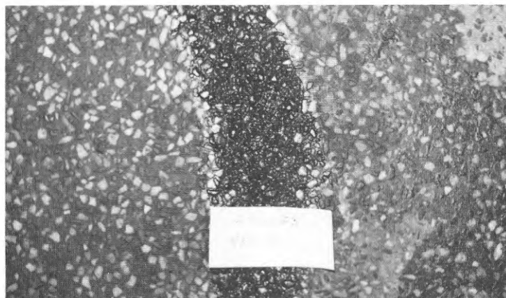
Bild 60. Terrazzogolv, skadat av syra.
