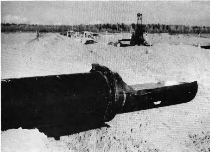
Fig. 2. Spridare vid pumphedningens mynning.
