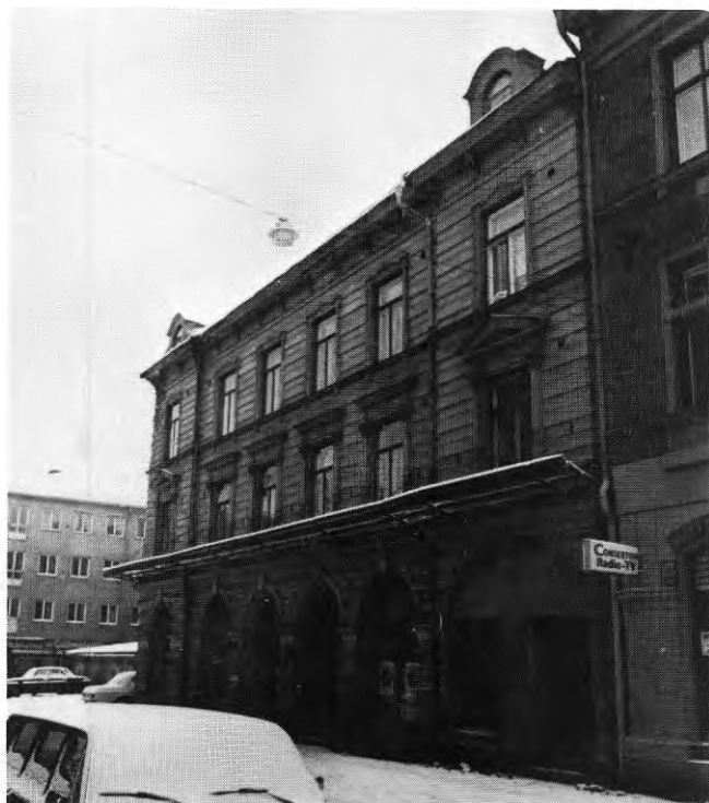
FIG. 9.7 Kv Cupido, Sundsvall 1971. Skydd mot nedfallande byggnads delar har måst sättas upp. Huset har senare rivits.
