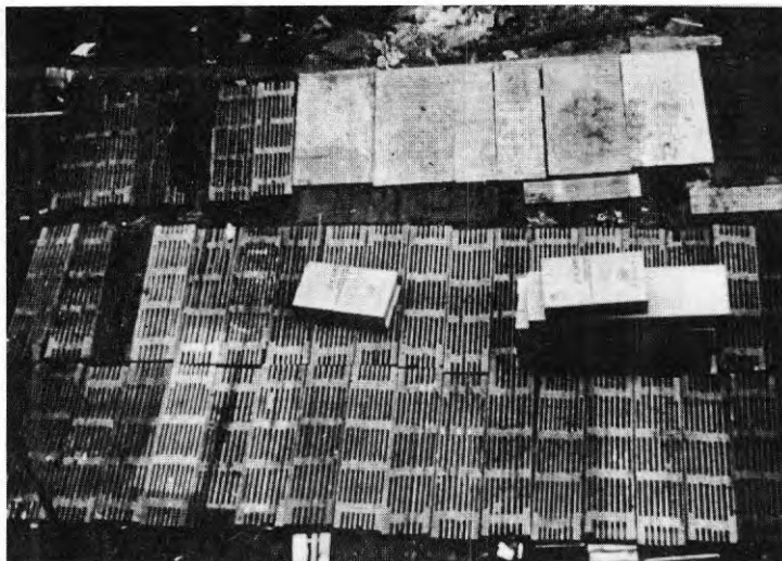
Figur 5.8 Förrådshållning på trall för byggnadsställning
