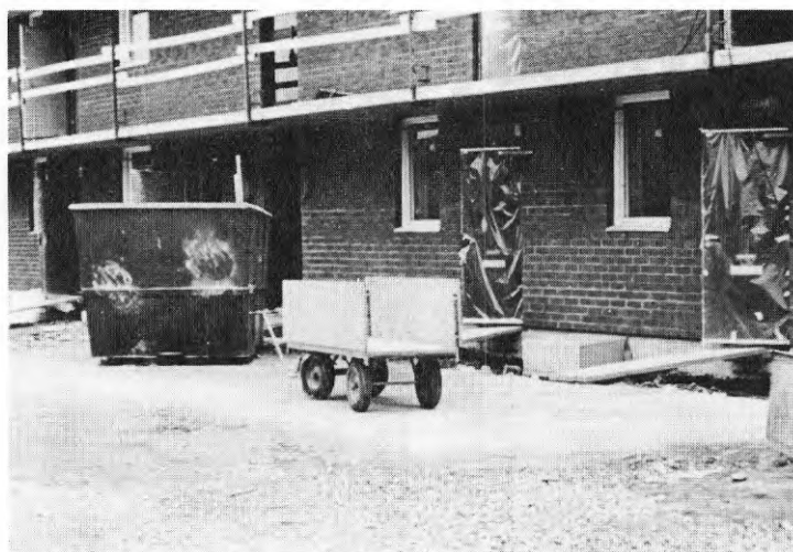
Figur 5.10 Förrådshållning på betongspill
