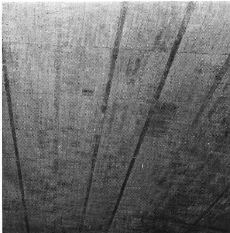
FIG. 93. Betong gjuten mot dels tidigare använda formluckor och dels mot nya utfyllnadsbräder mellan formluckorna.
