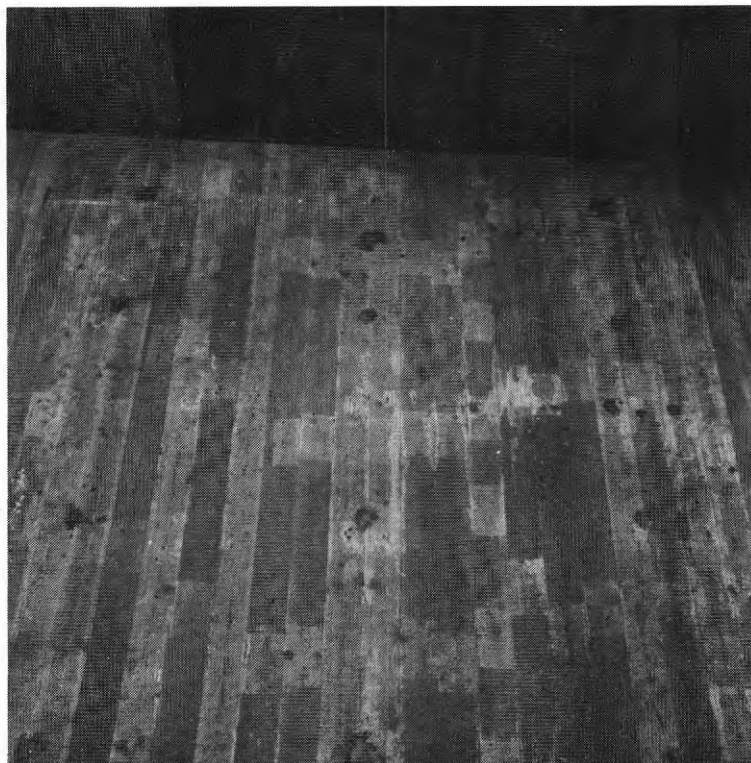
FIG. 94. Färgskillnader som orsakats av att vissa delar av formverket utsatts för långvarig solbelysning.
