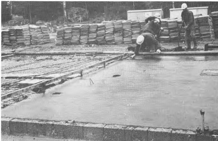
Fig 72 Platta på mark, lättklinker under. Glättning av överytan efter fullbordad betong- gjutning.
