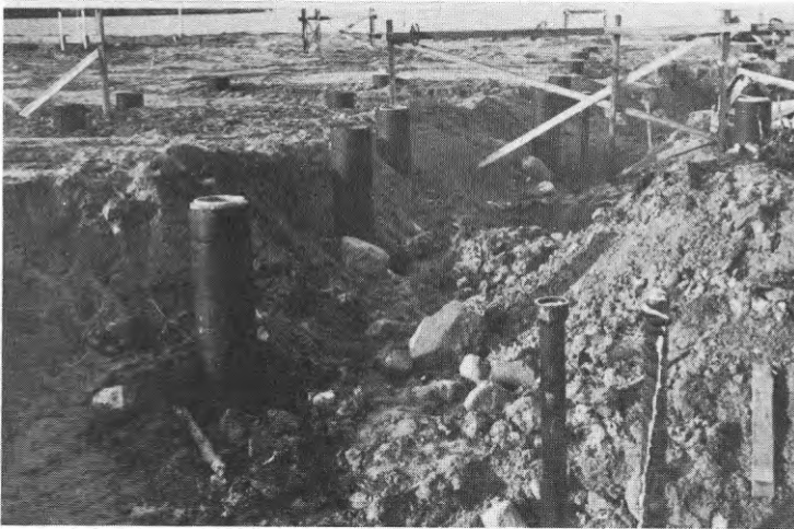
Fig 83 Grundförstärkning, special. Betongplintar bjudna i cementrör och lindade med glidskikt mot tjälfarlig fyllning.
