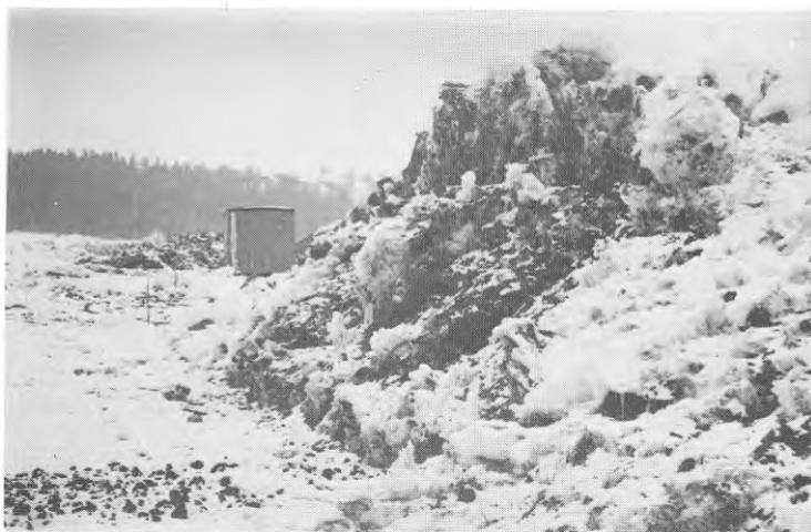
Fig 67 Arbetsplats i norrländskt område. Markbehandling i morän vintertid. 3-4 m höga drivor av is och grus efter avschaktning för fast grundläggning.
