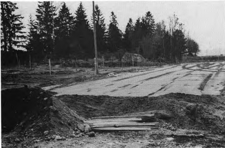
Fig 66 Arbetsplats i mellansvenskt område. Markbehandling i fast lera på hösten. Flytande grundläggning.
