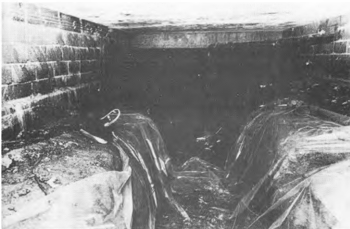
FIG. 55. En plastfolie blir inte alltid utlagd på rätt sätt. Stora ytor kan bli utan folie antingen p.g.a. slarv vid utläggningen eller p.g.a. att arbeten utförs i grunden efter det att folien lagts ut varvid denna helt enkelt vikts undan eller följt med när man krupit i grunden. När folien ligger i ett "dike" som på bilden händer det alltför ofta att det samlas vatten ovanpå folien och sedan avdunstar och bidrar till att höja luftfuktigheten i kryprummet.
