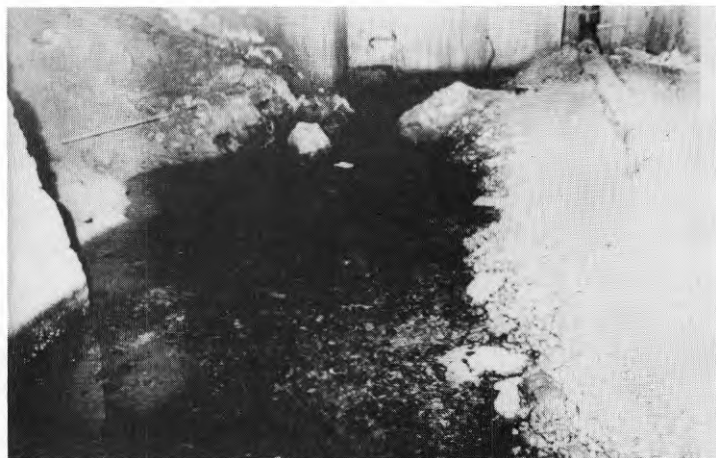
FIG. 53. Vattensamling i grund. Vattnet är klart och rent. Orsaken torde vara att dräneringsledningarna ligger för högt.
