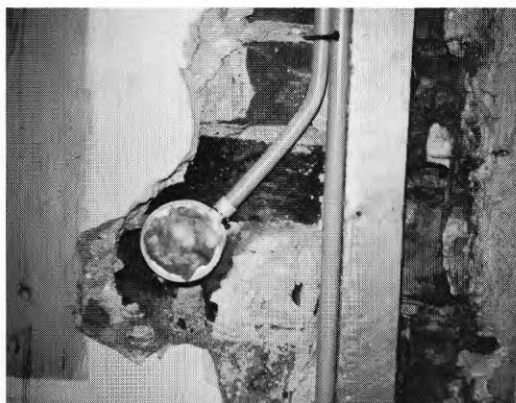
FIG. 14.4. Infälld dosa. Objekt B
