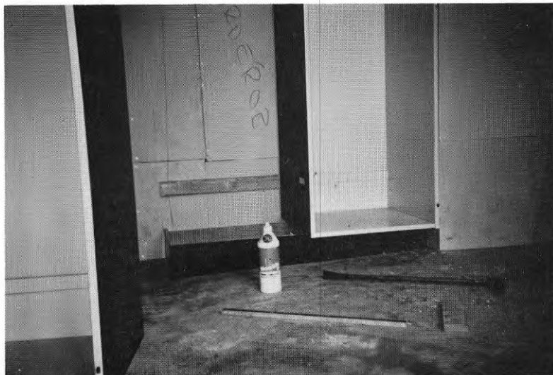
FIG. 11.1 som visar hur sparksockeln hyvlats på grund av lutande golv.
