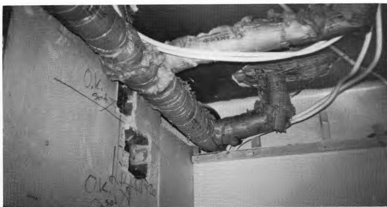
FIG. 13.1. Vatten- och avloppsledningar i undertak.
