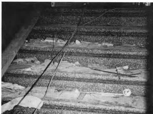
FIG 12.3. Ostädade trappor är en olycksfallsrisk.
