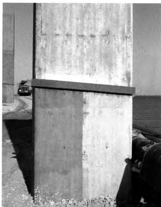
Fig. 4. Vatten på nyss avformad betong innebär oftast kalkutfällning. Pelaren i förgrunden fick en kraftig utfällning på sin sydsida vid första regnet som drabbade den. Vinden drev regnet mot denna sida. Norsidan däremot fick svagare utfällning och denna kom först långt senare, i samband med regn och nordlig vind, vilket är en ganska ovanlig kombination. Överskott på formolja och solstrålning kan ha ökat utfällningens intensitet. Under plankan har två kommersiella skyddsmedel provats med olika resultat. Tyvärr hade de omvänd effekt på norsidan. Pelaren i bakgrunden är nyavformad. Även den blev vit av kalkutfällning efter första regn.
