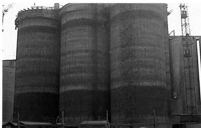
Fig. 2. Klimatet under gjutningen och tiden därefter har en avgörande betydelse för betongytors utseende i allmänhet och för kalkutfällningar i synnerhet. Kyla periodvis vid gjutningen störde den tidiga hydratationen och gav silorna de mörka banden. Dessa blev nästan helt vita av kalkutfällning efter första rejäla regn.
