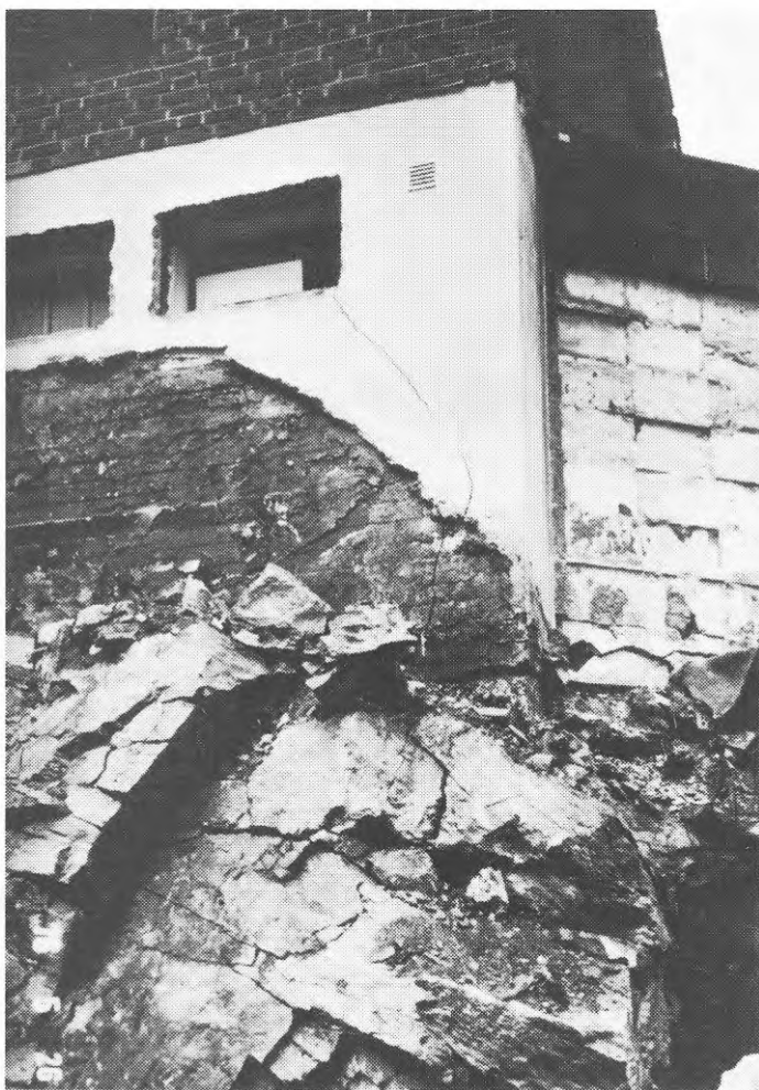
FIG. 26. Sprickor i berg och grundmur vid huvudbyggnadens sydöstra hörn efter sista salvan.
