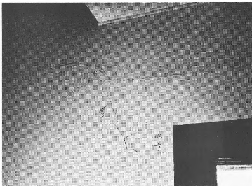
FIG. 28. Rum 3:7 genomgående finsprickor i östra väggen efter salva 3.
