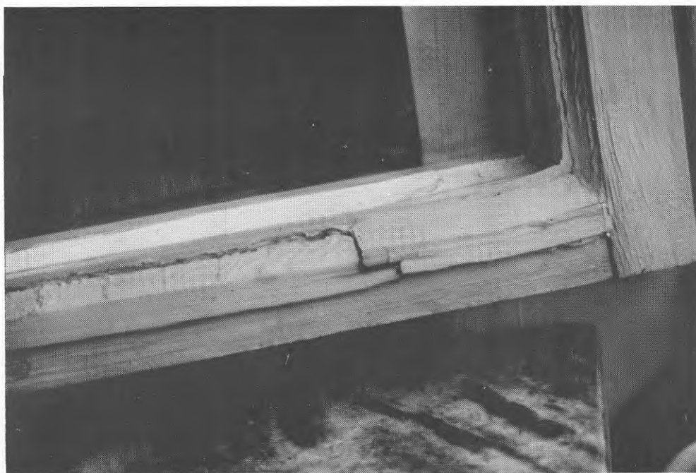
Bild 5. Rötskada i ytterbågens understycke förorsakad av dålig beslagning. Bågen har stått på karmbottenstycket.
