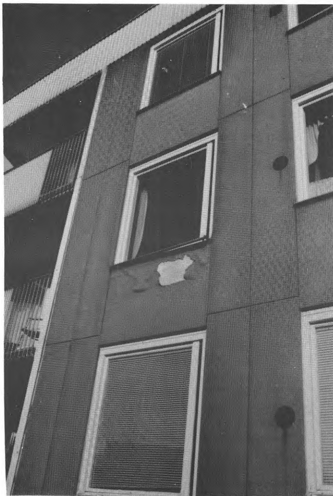
Bild 12. Fasad i lättbetong med utvändigt ytskikt av preobas. Blåsbildningen i ytskiktet mellan fönstren har orsakats av fukt.
