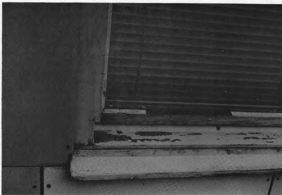
Bild 7. Rötskada i ytterbågens understycke. Kittfalsen har släppt från glaset och delvis fallit bort.
