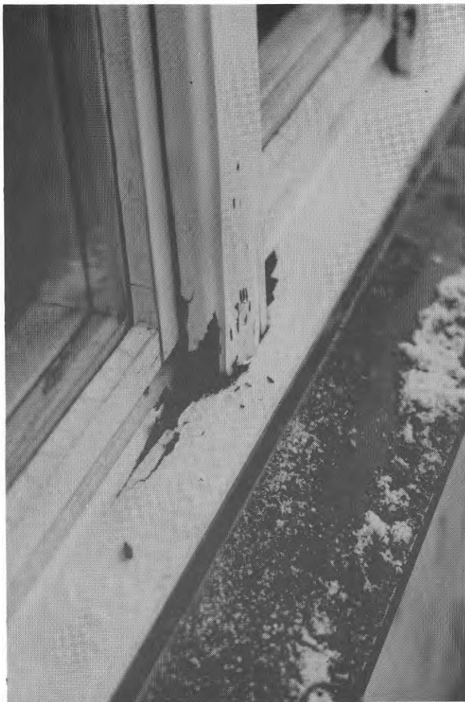
Bild 3. Rötskada i nedre del av mittpost och kring dennas anslutning i karmbottenstycket.
