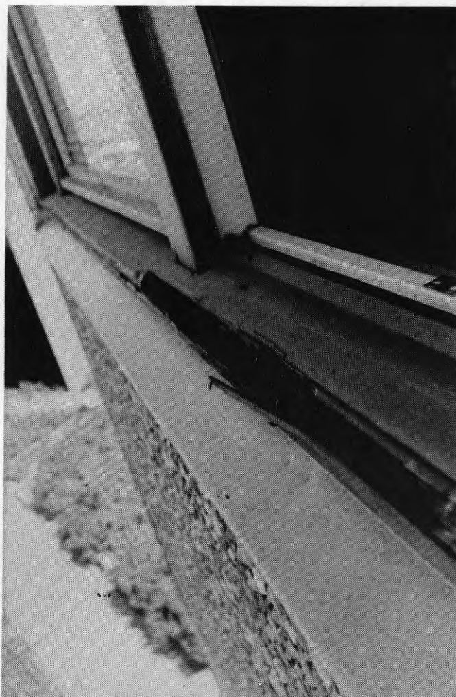
Bild 9. Rötskada i karmbottenstycke i anslutning till spår för fönsterbleck. Här har fönsterblecket fästs under karmbottenstycket istället för i det ursprungliga spåret, som lämnats helt öppet och svampbildning och rötskador har snabbt uppstått.
