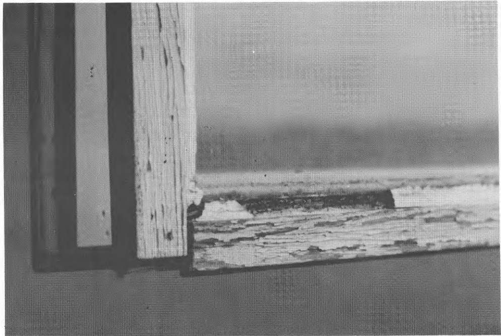
Bild 2. Rötskada i hörnsammanfogning av sidestycke - understycke på ytterbåge.
