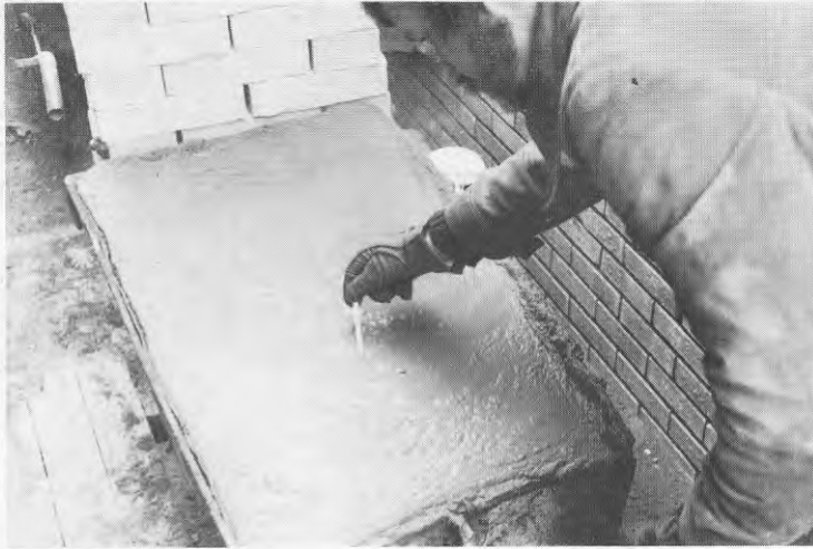
Fig 4 Mätning av brukstemp
