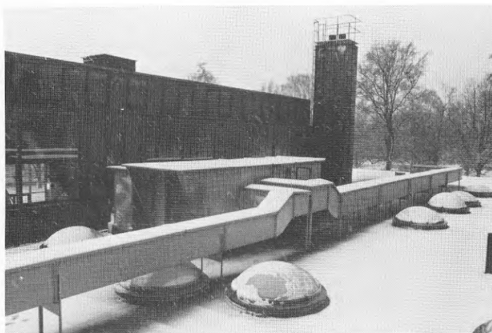
Figur 5.9. Foto av frånluftsaggregat med samlingskanaler.
