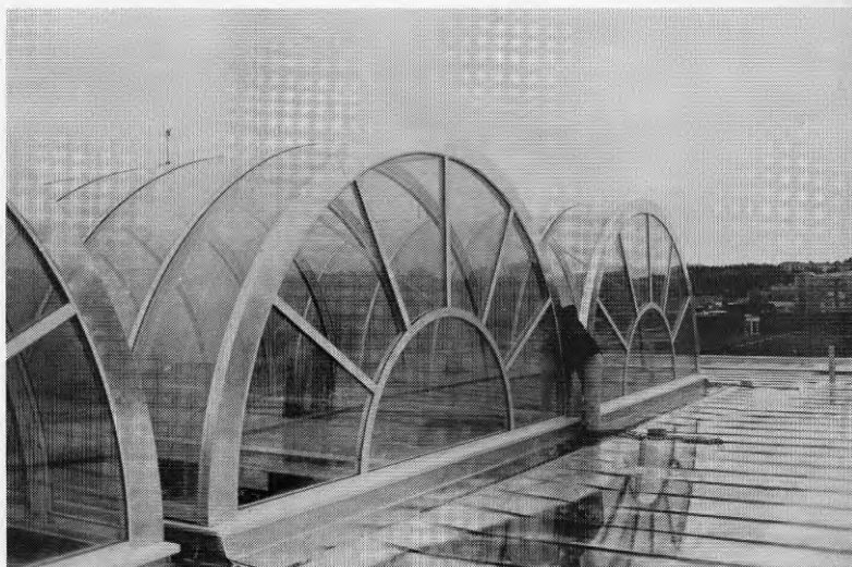
Bild 46 Kupoltak av polykarbonat i aluminiumpro- filer. Folk- sam Skadecenter
