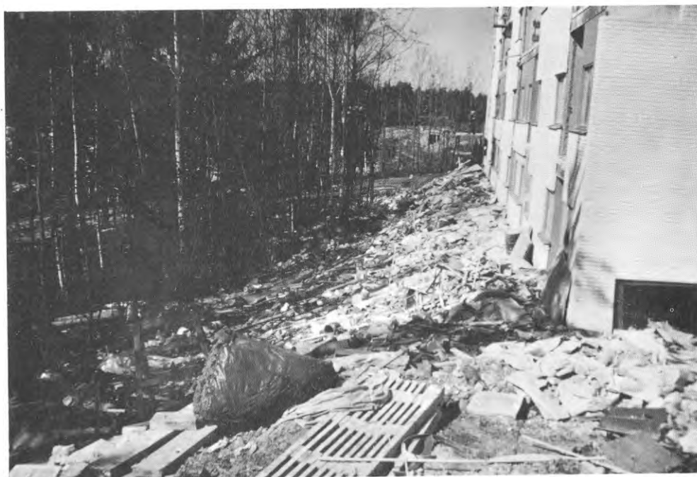
FIG. 4.4.3 Avfallet har kastats ned på marken och bl.a. hamnat i en brant slänt.
