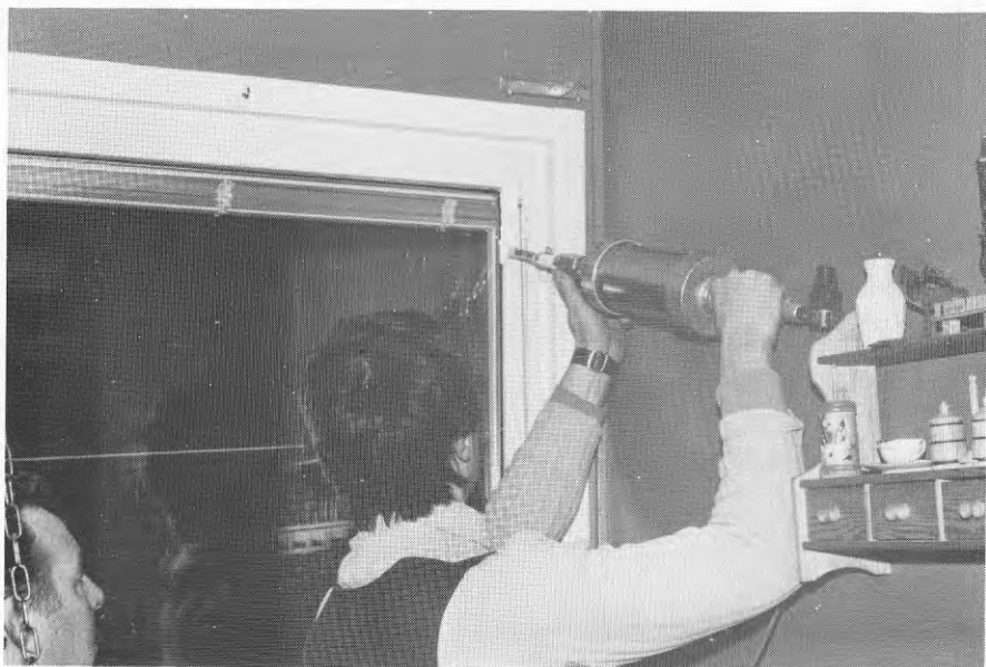
23 Insättning av 3dje rutan på innerbågens insida. Påläggning av Butylmassa) enligt Signa-metoden.
