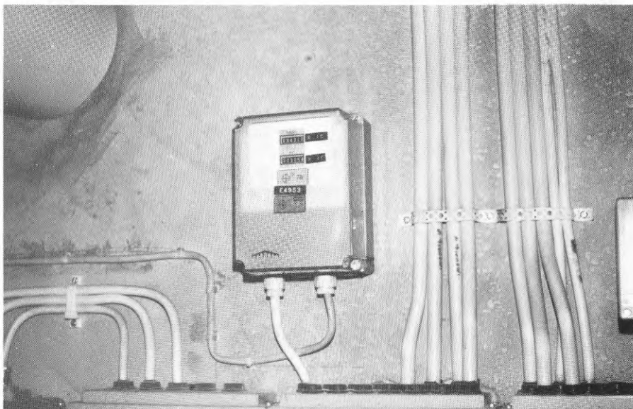
2 Registreringsverk för värmevärmemätare M 1 i undercentral UC 1.
