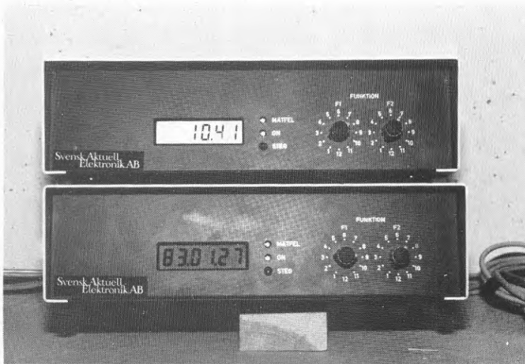
9 Mätare i trapphusförråd för temperaturmätning, närbild.
