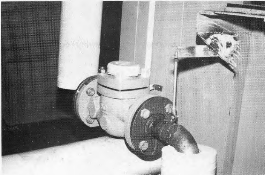
3 Varmvattenmätare invid värmeväxlare för varmvatten.
