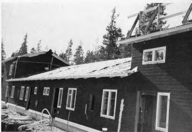
FOTO 4 : Slangpaket under montering på tak. Slangarnas uppgift är enligt uppfinnaren att vara solfångare under sommarhalvåret och värmesköld under vinterhalvåret.
